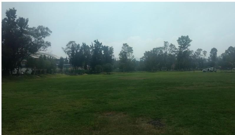
Foto No. 1. El relieve en la zona donde se ubica la Villa Centroamericana es semiplano, aunque es posible observar irregularidades en la superficie por presencia de asentamiento diferencial en el suelo.
